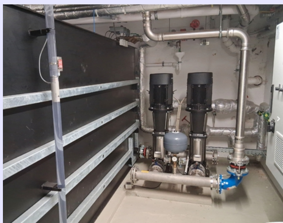
brandag Löschwasseranlage mit vor Ort geschweißtem PE-Löschwasserbehälter
