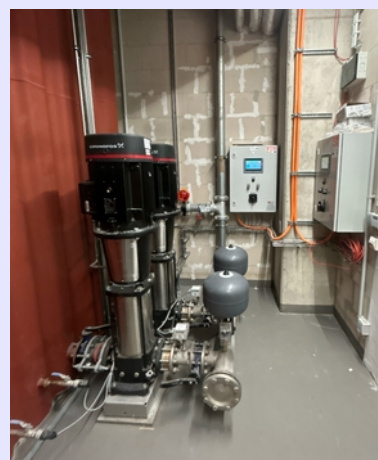
brandag Löschwasseranlage mit vor Ort geschweißtem Stahl-Löschwasserbehälter
